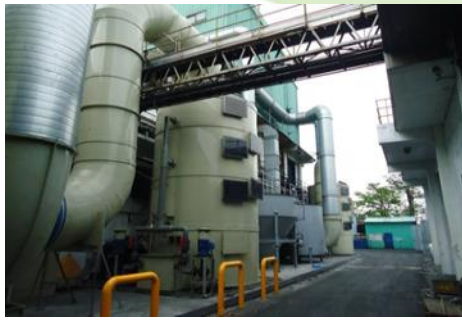
混練區防制設備
