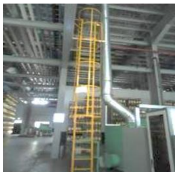
噴粉集塵設備
