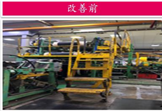
樓梯口安無人員管制裝置。
