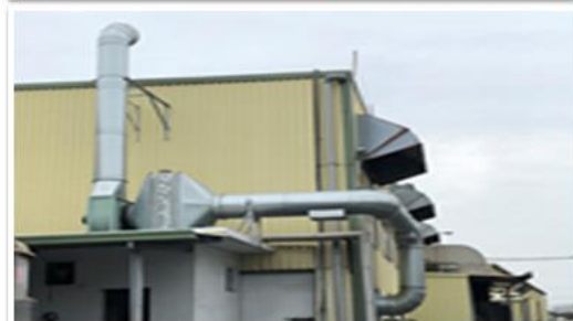
於作業區設置局部排氣裝置，廢氣經過活性碳過濾箱去除有害氣體後再排至室外。
