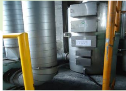
VOCs 作業區活性炭吸附設備
