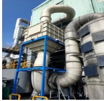
洗滌塔設備裝除霧器
