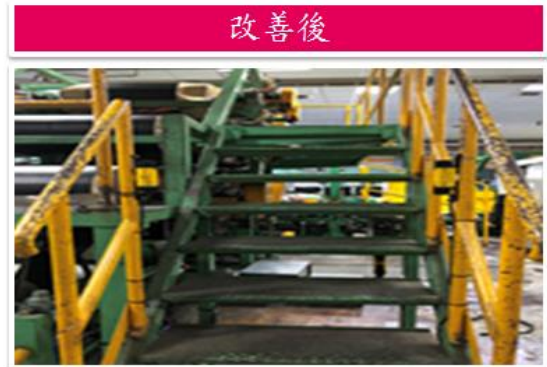
成型機樓梯增設光電感應器。人員經過樓梯口時，光電感應觸動後將機台強制切換為手動模式。
