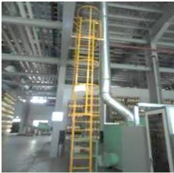
噴粉集塵設備
