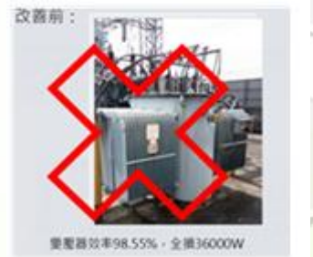
整合變壓器，原 11.4KV/3.3KV 變壓器停用
