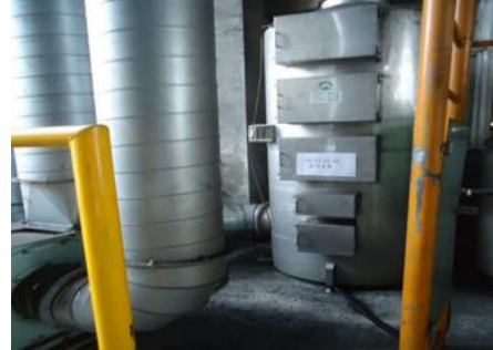
VOCs 作業區活性炭吸附設備
