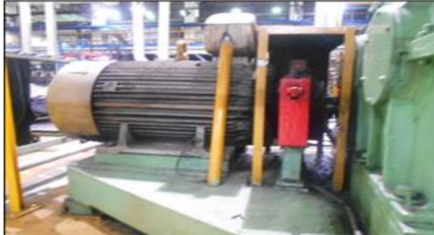
蓋膠機供料開煉機 125HP 馬達改變頻控制
