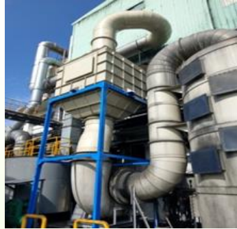
洗滌塔設備裝除霧器
