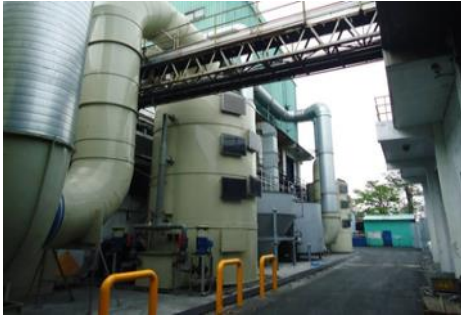
混練區防制設備
