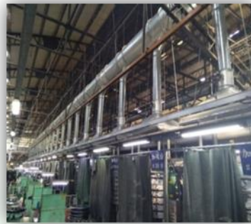
硫化區集氣收集處理系統
