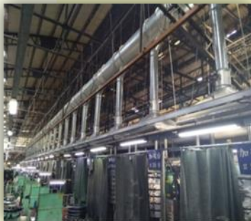
硫化區集氣收集處理系統
