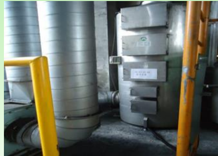
VOCs 作業區活性炭吸附設備
