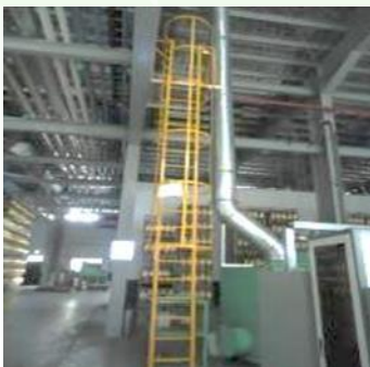
噴粉集塵設備
