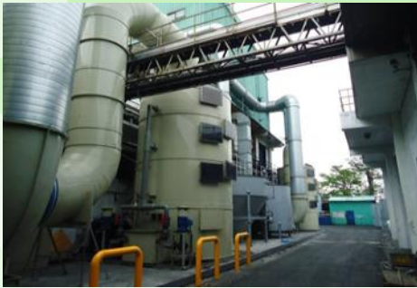
混練區防制設備
