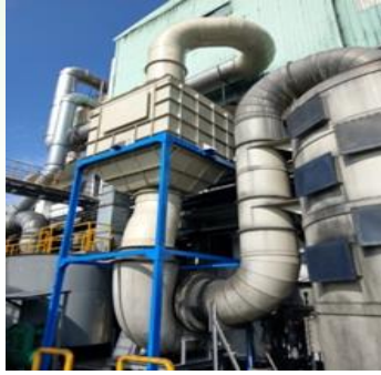
洗滌塔設備裝除霧器
